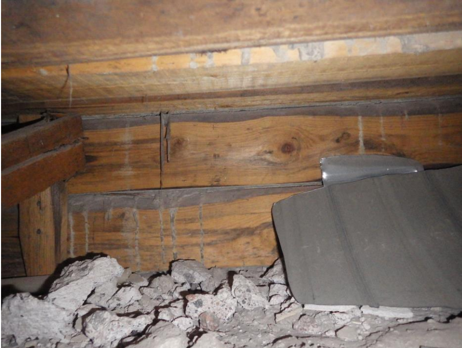
Kuva 18. Kuva rakennuksen välipohjan hyväkuntoisista muottilautoista, joita ei ole tarpeen poistaa rakenteesta, mutta joiden olemassaolo tulee huomioida korjauksissa. On huolehdittava siitä, että laudat eivät kastu jatkossakaan. Kuva AFRY Finland Oy.
