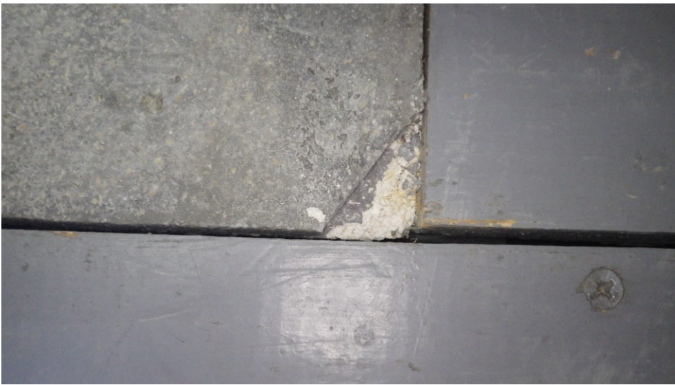
Kuva 3. Eräässä tilassa oli käyttäjien mukaan "sementtilattia", mutta rakennuksen kuntotutkimuksissa kuntotutkijat havaitsivat materiaalin olevan magnesiamaassaa, jossa on asbestia. Massan tunnisti alemmasta valkoisesta "laakerikerroksesta" ja asbestipitoisuus varmistettiin analyysillä. Kuva AFRY Finland Oy.
