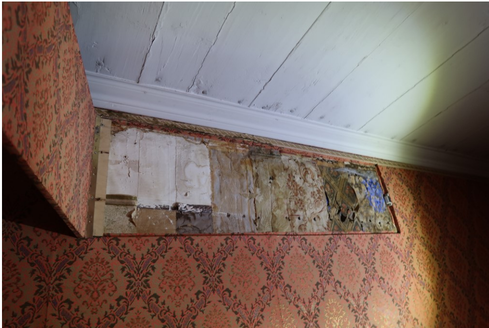
Kuva 12. Tapettien esiin otto kerroksittain on jätetty esille luukun taakse. Tapeteissa oli vanhoja ja uudempiakin kosteusjälkiä, mutta mikrobikasvua ei todettu. Kuva AFRY Finland Oy.
