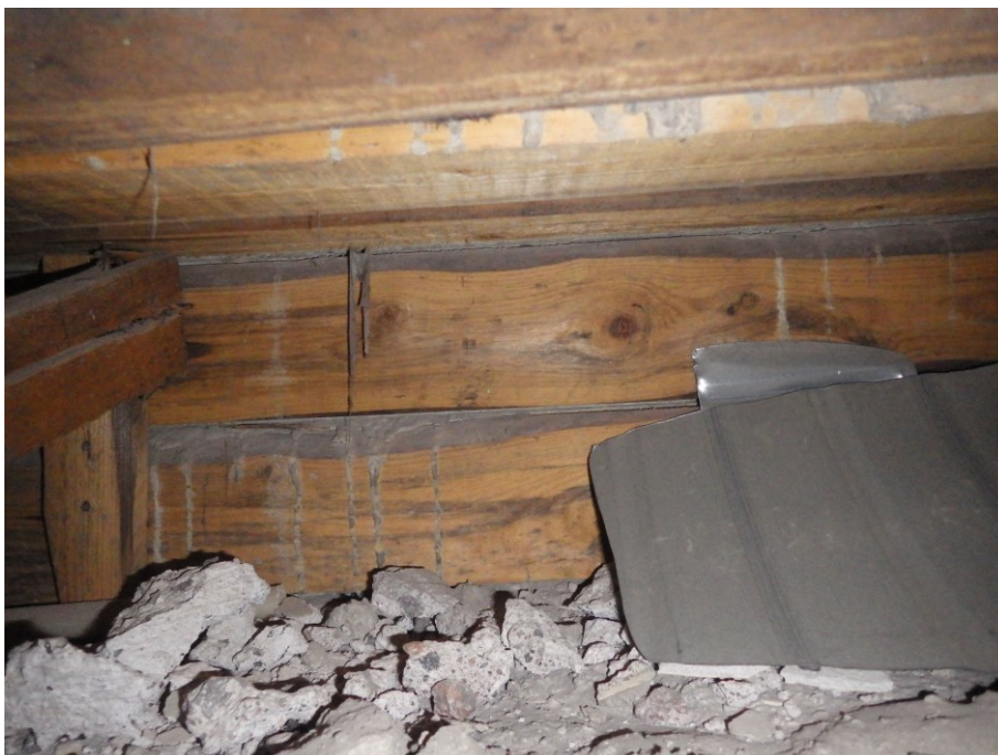
Bild 18. Bild av formbrädor i gott skick i byggnadens mellanbjälklag som inte behöver avlägsnas från konstruktionen, men vars existens ska beaktas vid reparationerna. Man bör se till att brädorna inte heller i framtiden blir våta. Bild AFRY Finland Oy.
