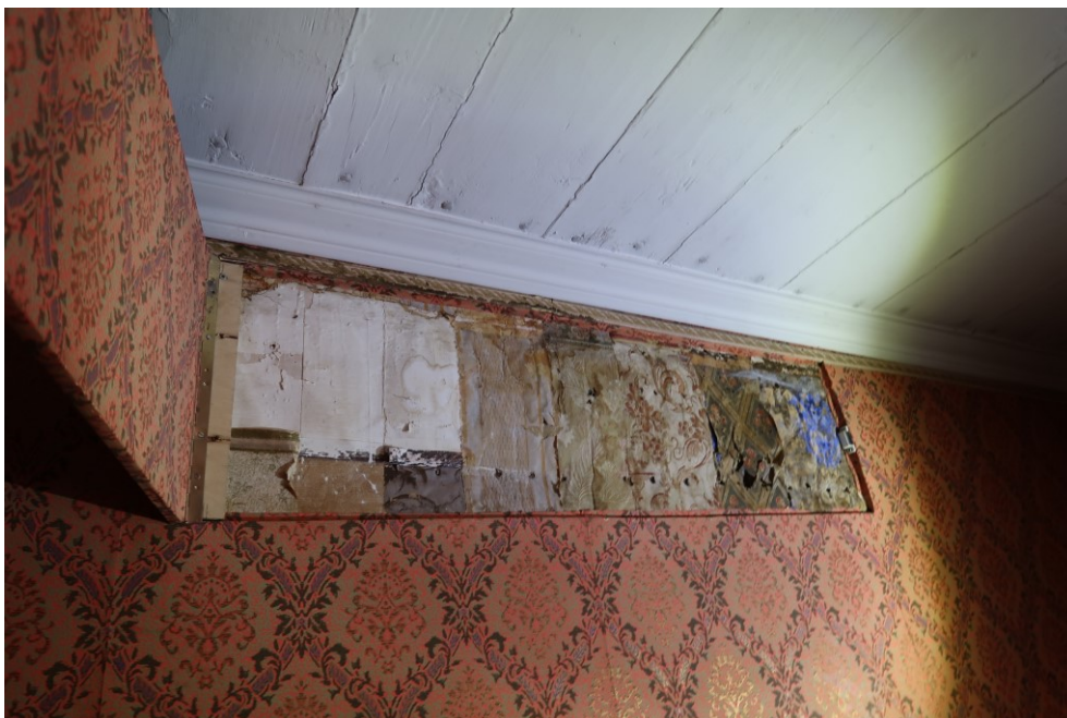
Bild 12. Den skiktvisa framtagningen av tapeterna har lämnats framme bakom en lucka. Tapeterna hade gamla och nyare spår av fukt, men ingen mikrobiltillväxt konstaterades. Bild AFRY Finland Oy.
