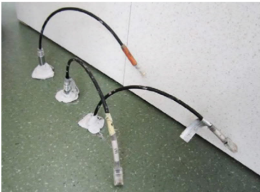
Kuva 24. Muovimatolla päällystettyyn betonilattian kosteusjakauman selvittämiseksi lattiarakenteeseen on porattu kolmelle eri syvyydelle reiät, joihin asennettu suhteellisen kosteuden mittapäät tasaantumaan mittauksen ajaksi (YO2016).
