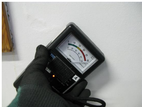
Kuva 8. Kosteutta ulkoseinän sisäpinnassa.
